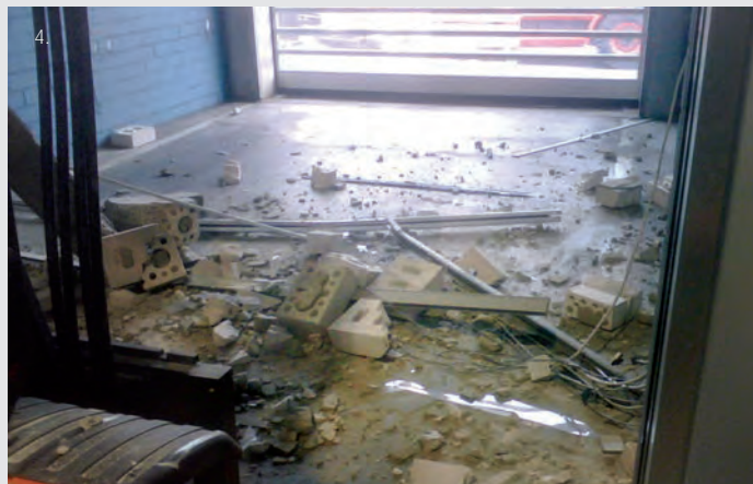
4. Vorsicht! Staplerunfälle können weiterreichende Schäden verursachen
